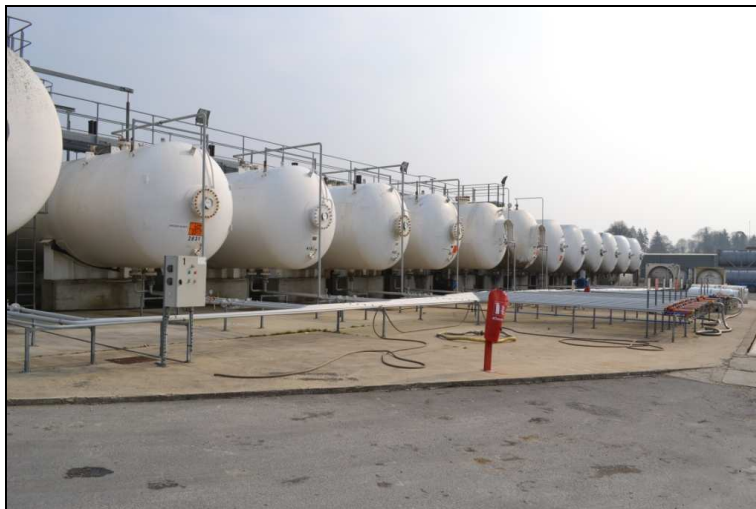
Cuves fixes au niveau du pont-bascule 1
