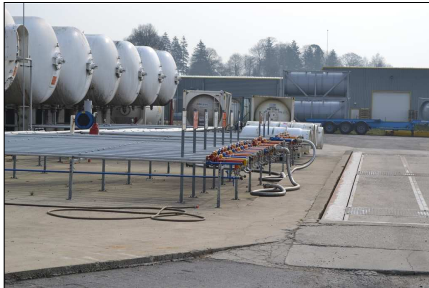
Aire de dépotage au niveau du pont-bascule 1
